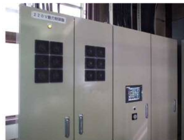
熱源自動制御盤
