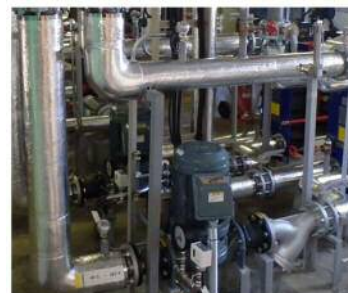
循環ポンプ周り
